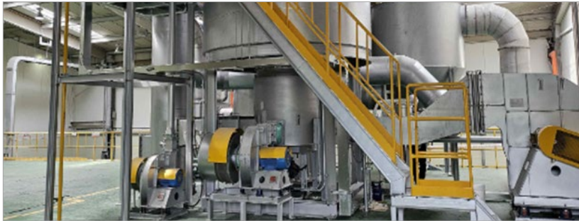
시화공장 '직접 연소에 의한 시설(RTO)'
