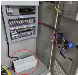
UPS 장치 설치
